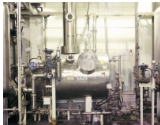
アルコール蒸留還元装置
